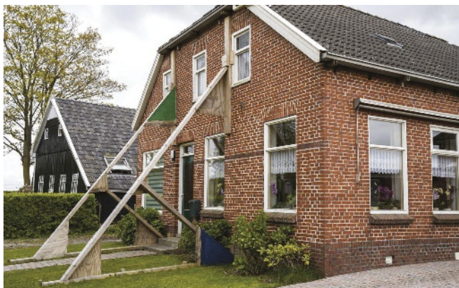
Figuur 15 Mijnbouwschade Groningen (bron: dvhn.nl)
